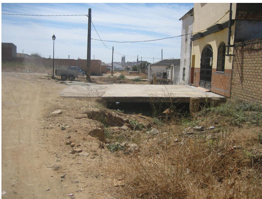
Foto 3. A unos 100 metros del punto anterior el arroyo ocupado por una vivienda.
