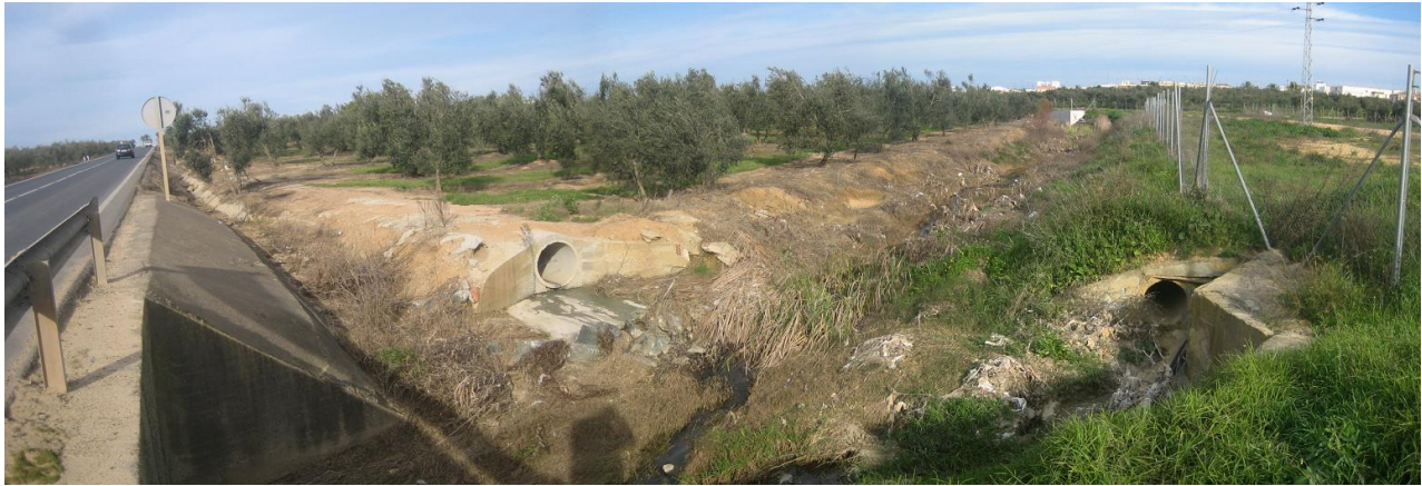
Desde la carretera A-8052 (Coría a Sanlúcar) se observan varios emisarios de aguas pluviales y la cuneta de la carretera hormigonada. El lecho del arroyo presenta suciedad y signos de contaminación. A partir de este punto, los signos de erosión se agravan considerablemente.
