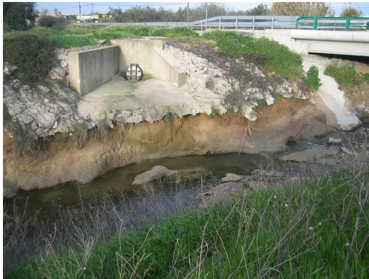
Uno de los emisarios de aguas pluviales en el Riopudío, en el término de Almensilla. Se puede observar la fuerte erosión provocada en el lecho del arroyo.
