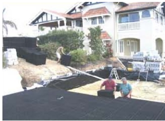
Figura 11. Depósito de detención enterrado.
