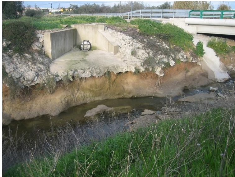
Aliviadero de la red de aguas residuales directa al arroyo Riopudio, en Almensilla. Latitud 37°18'49.26"N Longitud 6° 5'22.64"O
