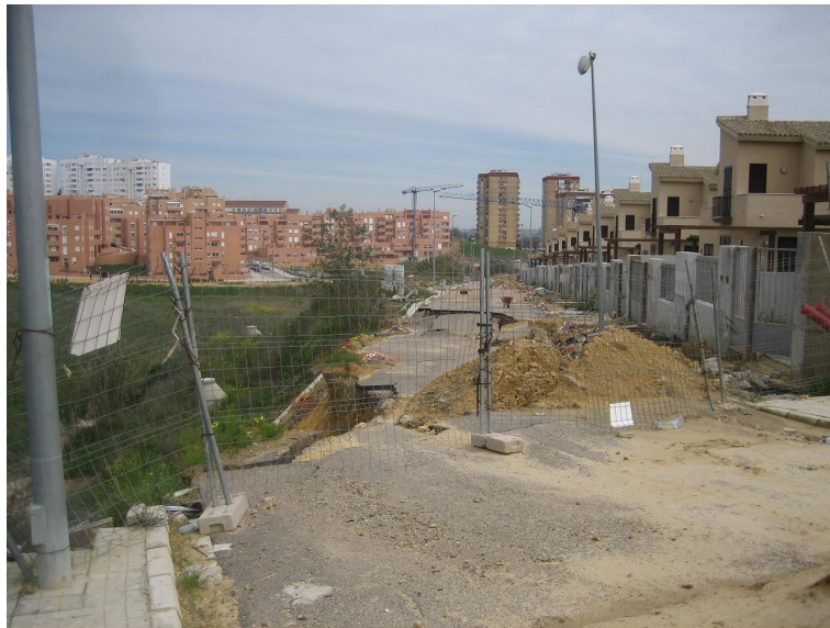
La mayor erosión se produce en las cotas más bajas como consecuencia del mayor volumen y velocidad del agua, por la urbanización y sellado de la parte alta de la cornisa. En la foto, una calle de Camas, antes de estrenarse, se ha desplomado.
