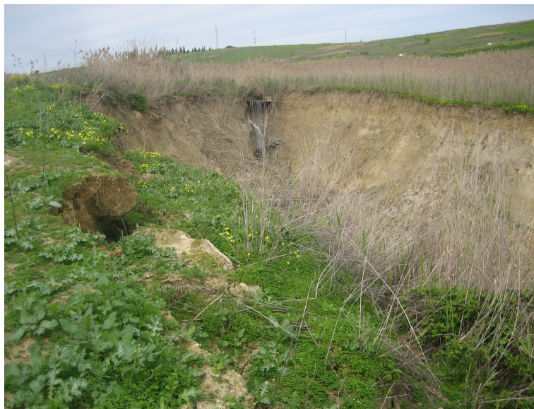
El desplome avanza aguas arriba. Está ya unos metros y amenaza a la conducción de Emasesa de agua a Sevilla.
