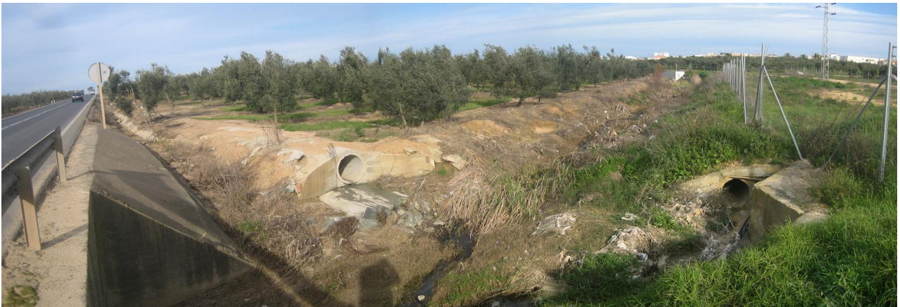
Desde la carretera A-8052 (Coria a Sanlúcar) se observan varios emisarios de aguas pluviales y la cuneta de la carretera hormigonada. El lecho del arroyo presenta suciedad y signos de contaminación. A partir de este punto, los signos de erosión se agravan considerablemente.
