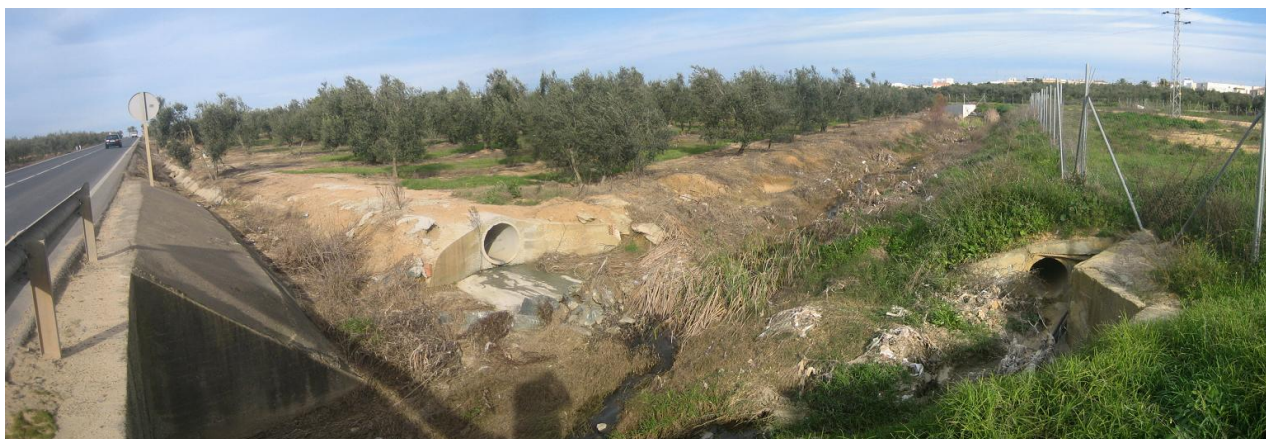
Desde la carretera A-8052 (Coria a Sanlúcar) se observan varios emisarios de aguas pluviales y la cuneta de la carretera hormigonada. El lecho del arroyo presenta suciedad y signos de contaminación. A partir de este punto, los signos de erosión se agravan considerablemente.
